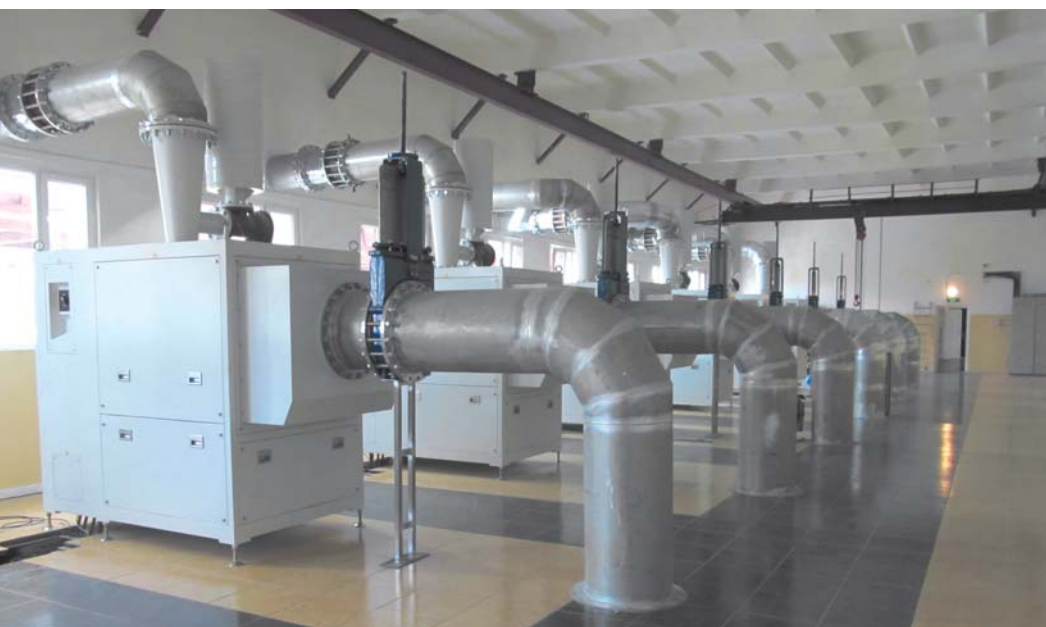
Рис. 2. Воздуходувная станция ОСК г. Подольска
