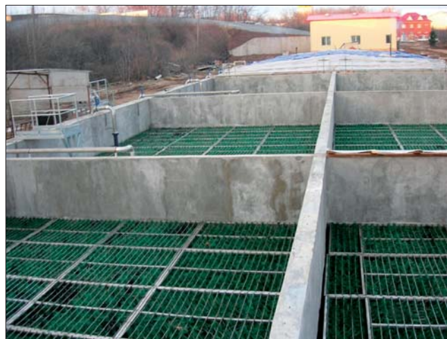
Рис. 10. Блок доочистки с ершовой загрузкой
