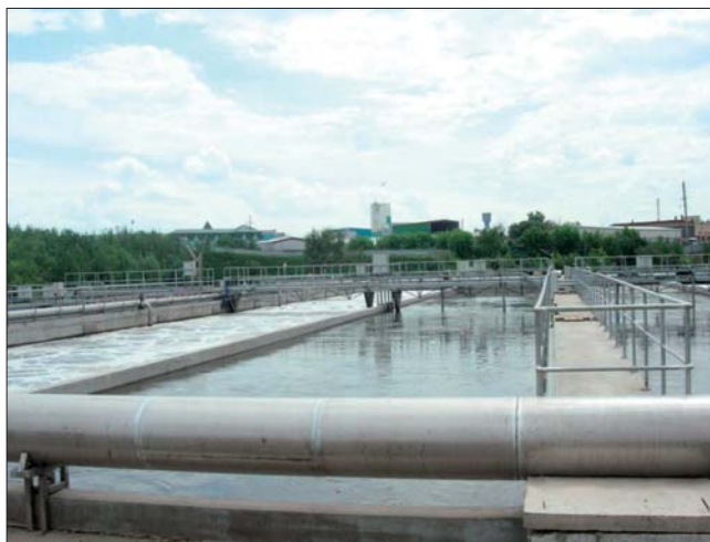
Рис. 1. Реконструированный блок аэротенков и вторичных отстойников
